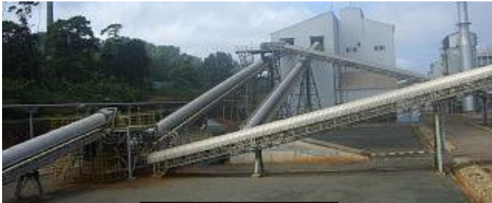
プラント内搬送設備
